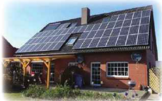
民宅光伏发电系统
